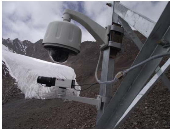
图 2 1 号冰川监测塔上安装的动力实时监测系统
