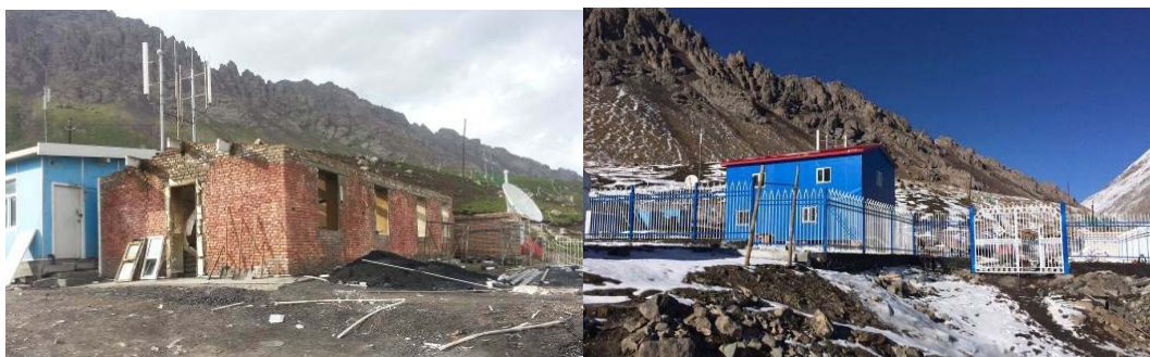
图 建于 20 世纪 90 年代的砖房,由于地基下沉,墙体已严重开裂; 新落成的二层彩钢板房,红顶蓝墙,在纯净如洗的蓝天白云的映照下,分外醒目耀眼
